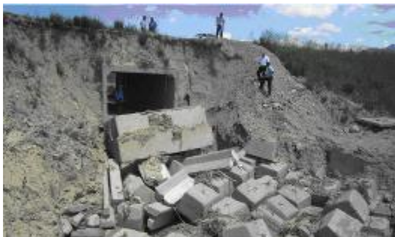
Рис.1. Разрушенные участки дороги в результате потери несущей способности основания
